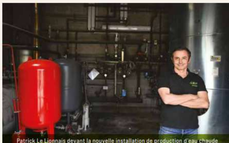
Patrick Le Lionnais devant la nouvelle installation de production d'eau chaude
